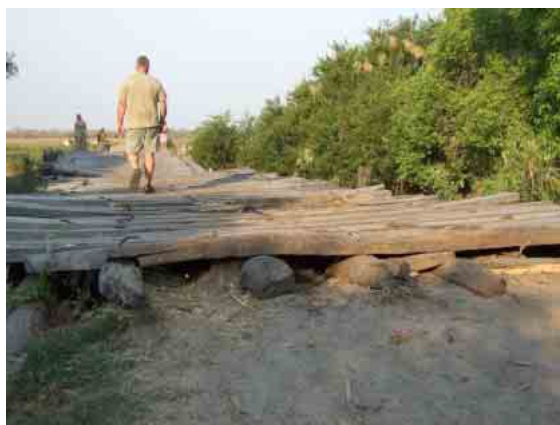
Die kaputte Holzbrücke
