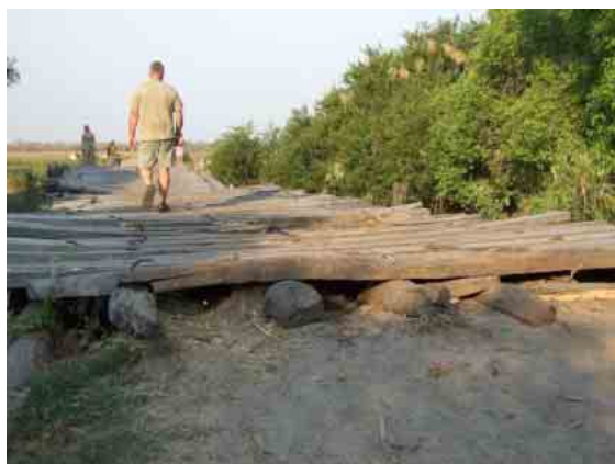
Die kaputte Holzbrücke
