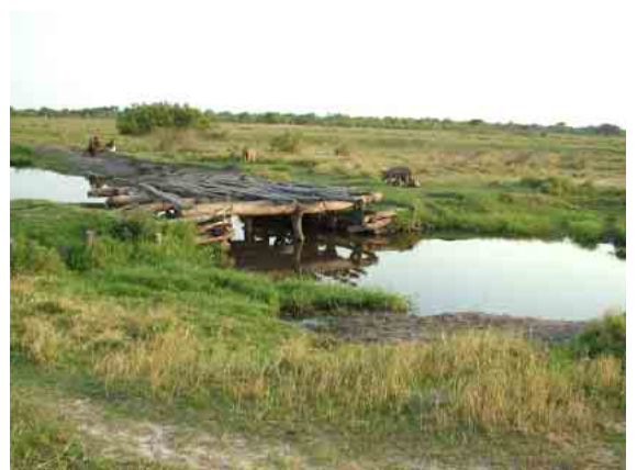
Zerstörte Brücke über den Lueti
